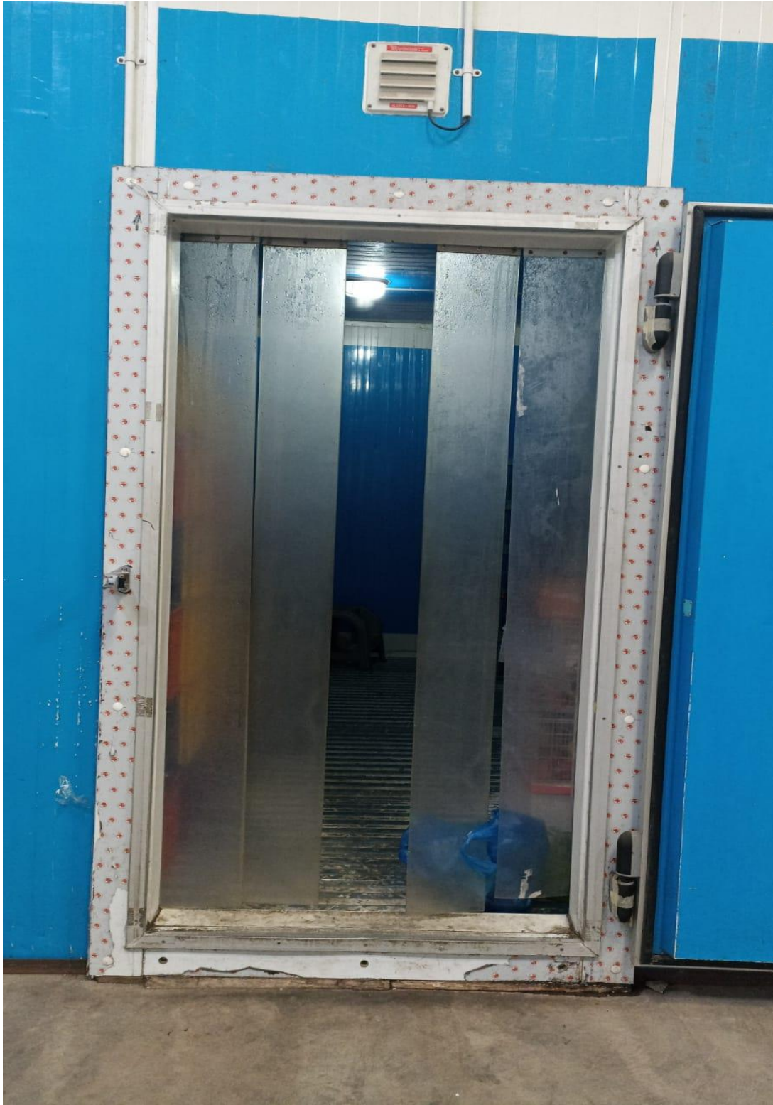
Lampiran 2 Pintu Masuk Chiller
