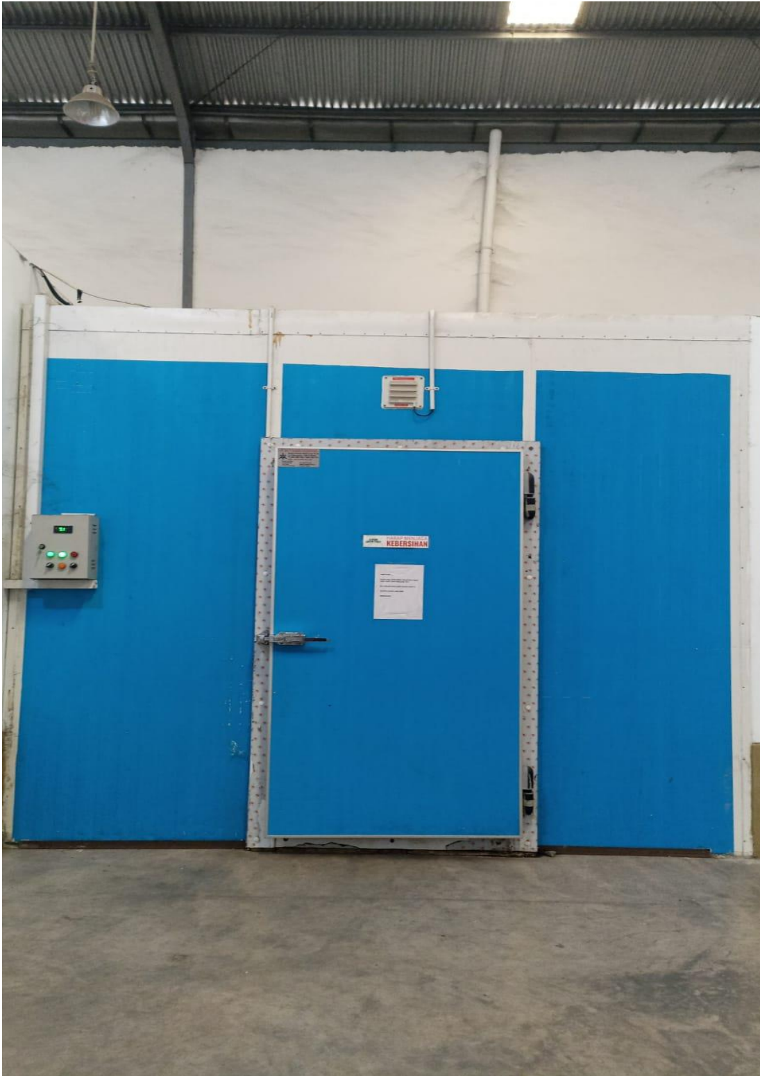
Lampiran 3 Chiller Dari Depan
